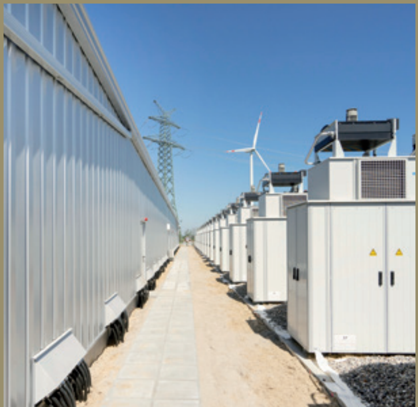
InspireME, de grootste batterij van Europa staat in Duitsland. Gebouwd door Eneco en Mitsubishi Corporation. Foto: Eneco
